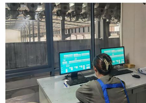
配料控制系统 Batching control system
